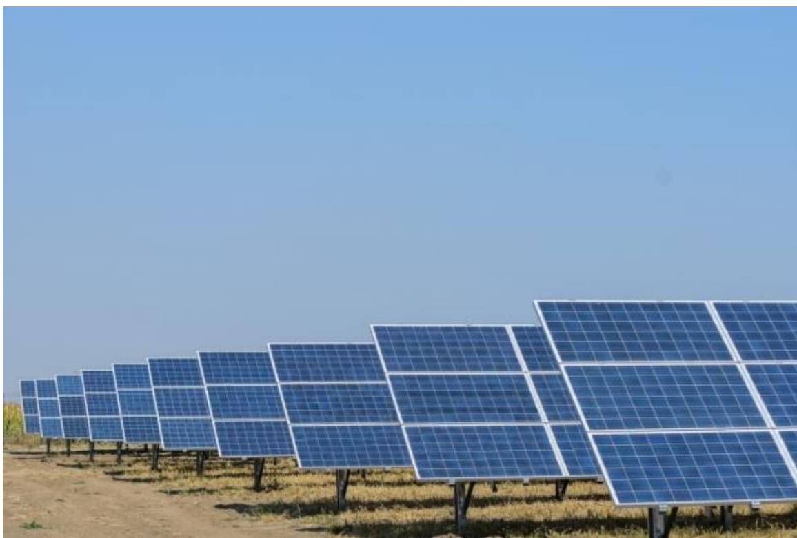
Foto af solcelleanlæg.
